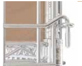
Cubierta protectora en los extremos de los cables expuestos.
